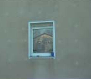
“Leopardeneffekt”: Algenbewuchs über Dübeln bleibt aus (Wärmebrücke Dübel)
