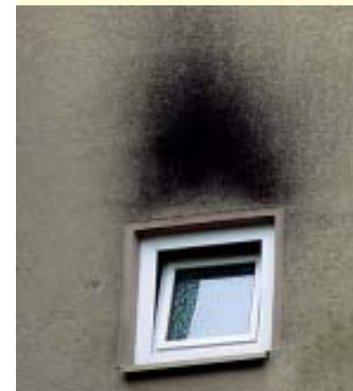
Besonders starker Pilzbefall über einem Fenster (Feuchtluftaustritt Badezimmer)
