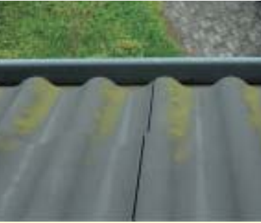
Algen auf Betondachstein
