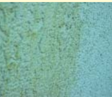
Hoch Wasser abweisender Putz (Tauwasser auf der Oberfläche)
