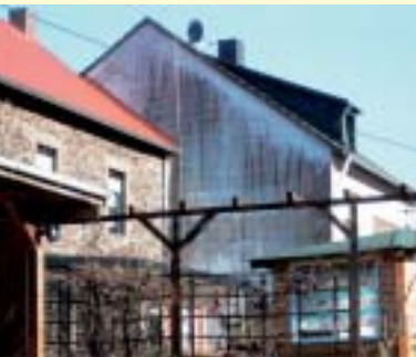
Pilzbefall auf wetterseitigem Giebel
