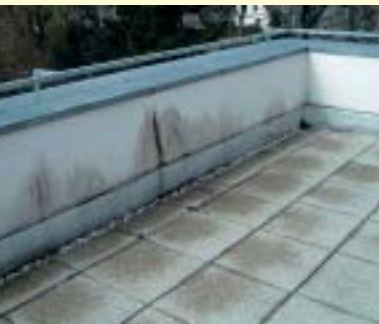
Algen sind an Brüstungen sehr verbreitet (mangelhafte Wasserführung)
