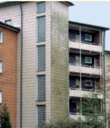
Algen auf Vorhangfassade
