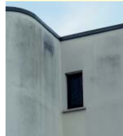
Pilzbewuchs auf dem Anstrich eines glatten Putzes (fehlender Dachüberstand)
