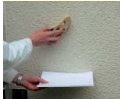
Reinigungspotenzial eines 10 Jahre alten Kratzputzes
