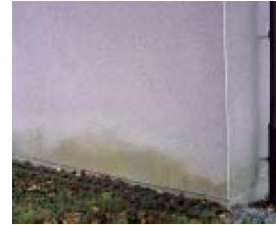
Typische Veralgung an der Hausfassade (fehlende Sockelausbildung)
