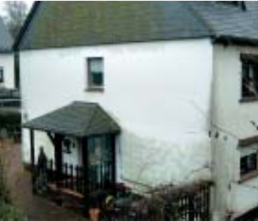
Wetterseite einer Fassade mit Algenbefall auf Schieferplatten
