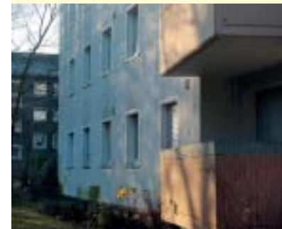
Hoch Wasser abweisende Fassade mit Algen im unteren Bereich (Tauwasseranfall morgens)
