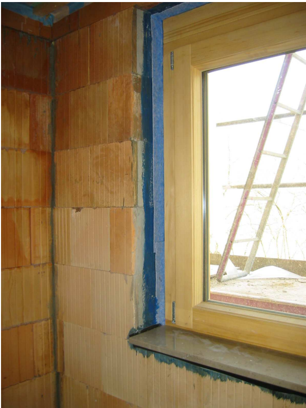
Bild 2: Im Rohbauzustand bereichsweise durchnässtes HLz-Mauerwerk.
