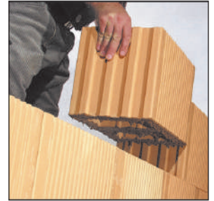
Nachdem die erste Schicht auf Mörtel versetzt ist, wird noch nicht verfüllt, sondern mit Dünnbettmörtel die Wand in ihrer gesamten Höhe erstellt.
