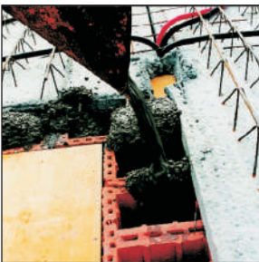
Die Befüllung des Planfüllziegels wird mit Beton C12/15 (Körnung 0-16, mit BV) durchgeführt. Danach kann die Decke betoniert werden.
